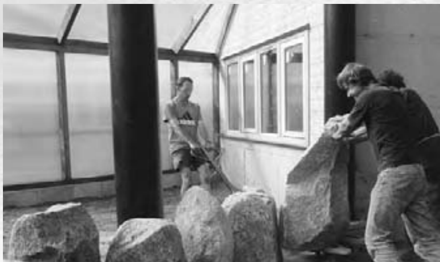
Drivhuset blir bl.a oppvarmet av varm overskuddsluft som blir hentet ned fra mønet og gjennom rør blåst inn i vegggen og i store steinlagte dammer.
